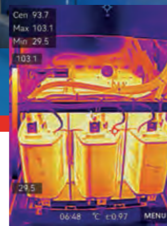
Thermografieaufnahme von Transformatoren eines Stromversorgungssystems
